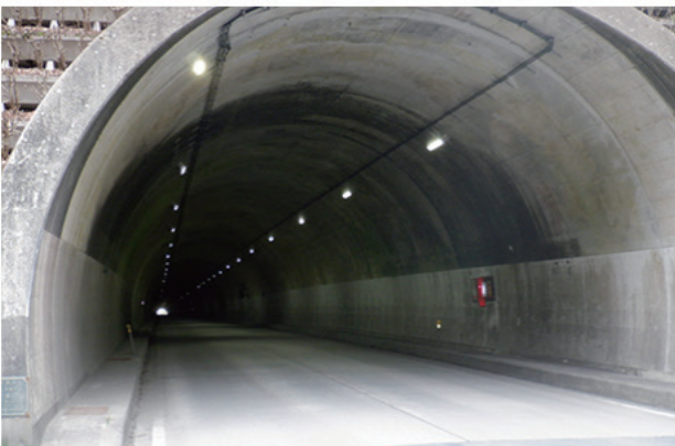
トンネル照明設備
