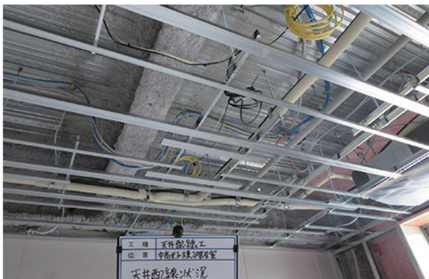
建設電気設備 配線状況
