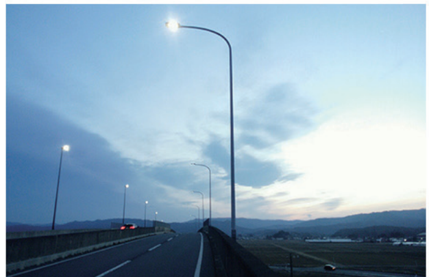
道路照明設備
