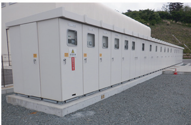
プラント電気設備 受変電設備
